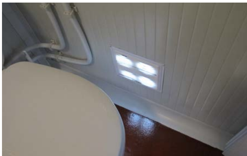
Fig. 3.3.06 ► Ventilación en aseo.
