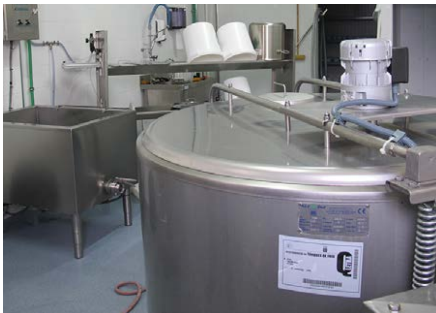
Fig. 55 ► Tanque de frío en la sala de elaboración de una quesería.
