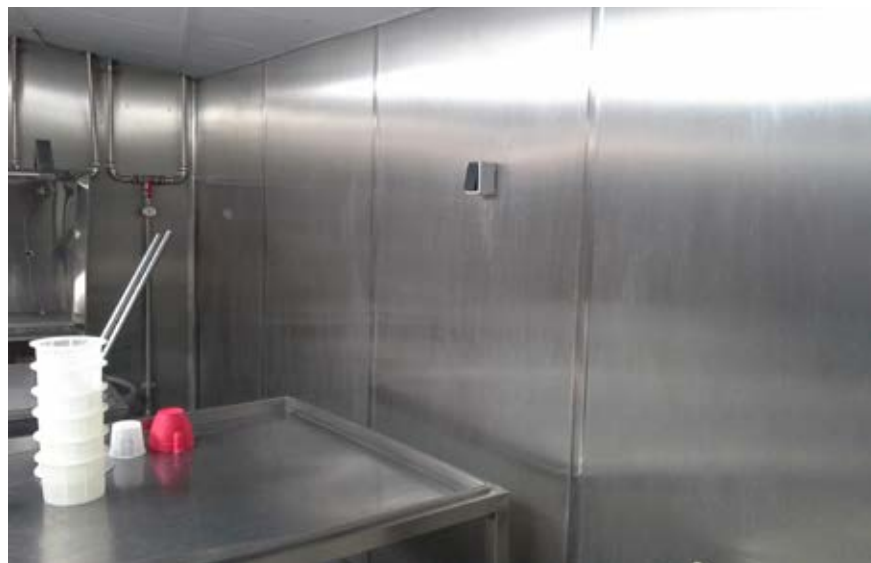
Fig. 3.2.09 ▶ Paneles metálicas de la pared.
