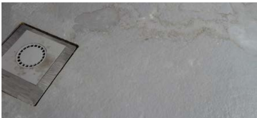
Fig. 3.2.07 ► Sumidero en suelo.
