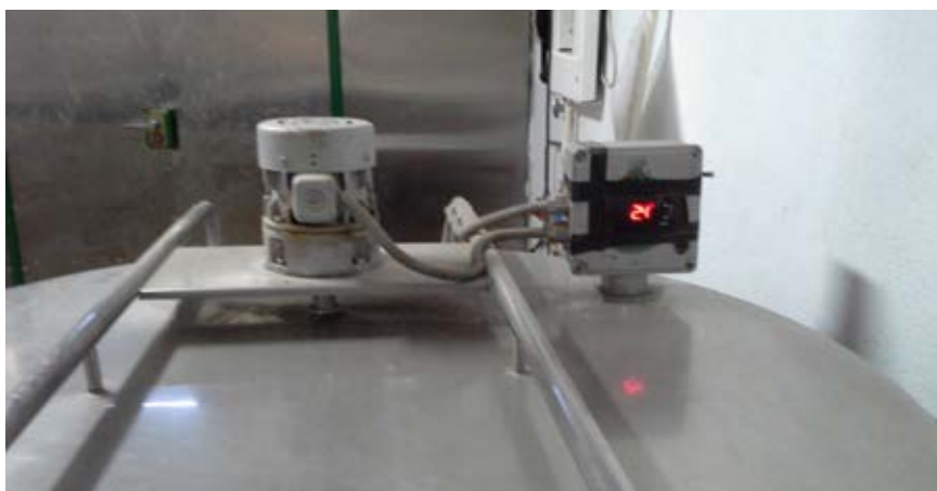
Fig. 3.2.21 ► Temperatura del tanque.
