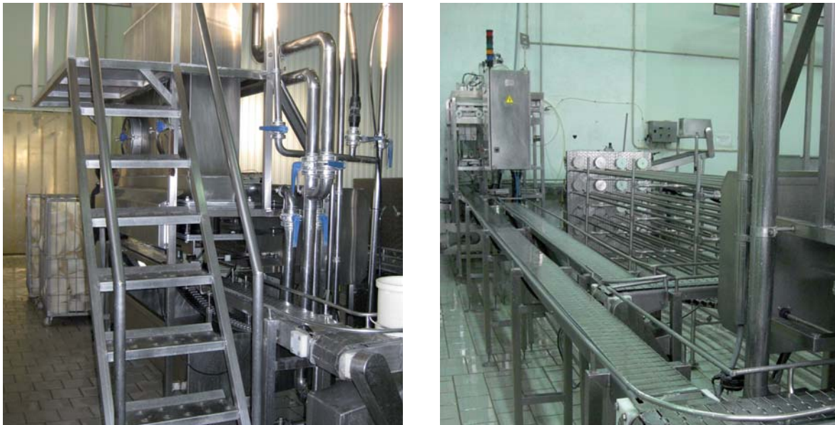
Imagen 5.4. Maquinaria e instalaciones en una fábrica de elaboración de queso
