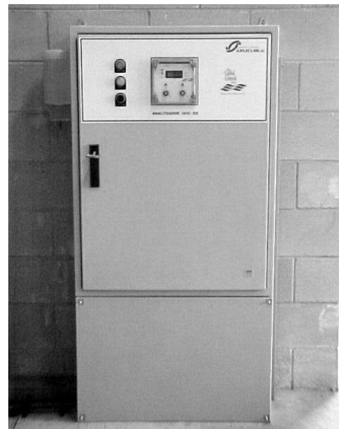
FIGURA 16. Analizador automático de cloro (Aigües del Prat, SA).
