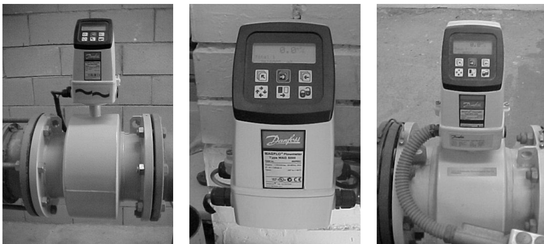
FIGURA 17. Contadores de caudalímetros en tuberías (Aigües del Prat, SA).
