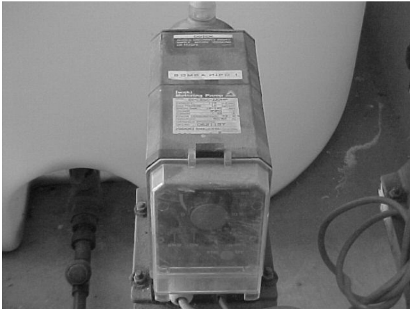
FIGURA 14. Bomba dosificadora de hipoclorito (Aigües del Prat, SA).
